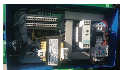
KONTROLNO UPRAVLJAČKI PANEI CONTROL PANEL
