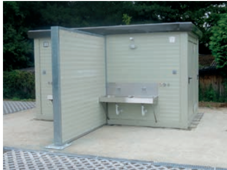
Warmwasseranlage, Exklusiv Sanitär
