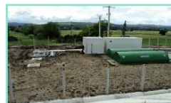
BIOREAKTORSKA POSTROJENJA BIOREACTOR PLANTS
