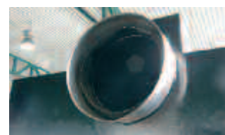
Prikaz ulazne cijevi separatora
