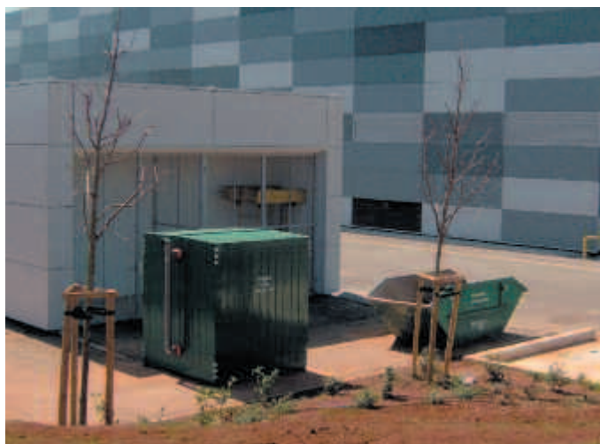
Spremište zapaljivih tekućina na lokaciji
