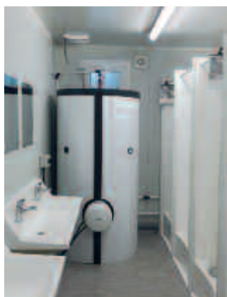
Spremnik za toplu vodu
