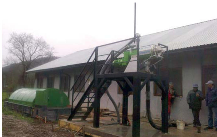
Pročišćavanje otpadnih voda iz farme svinja Waste water purification from pig farms
