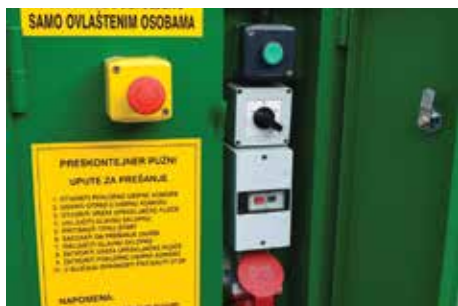
UPRAVLJAČKO-ENERGETSKI BLOK CONTROL POWER UNIT
